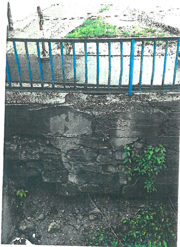
4.1.6.a/ Az Árok utca – Szabadság út találkozásánál lévő hídláb tönkremenetele
