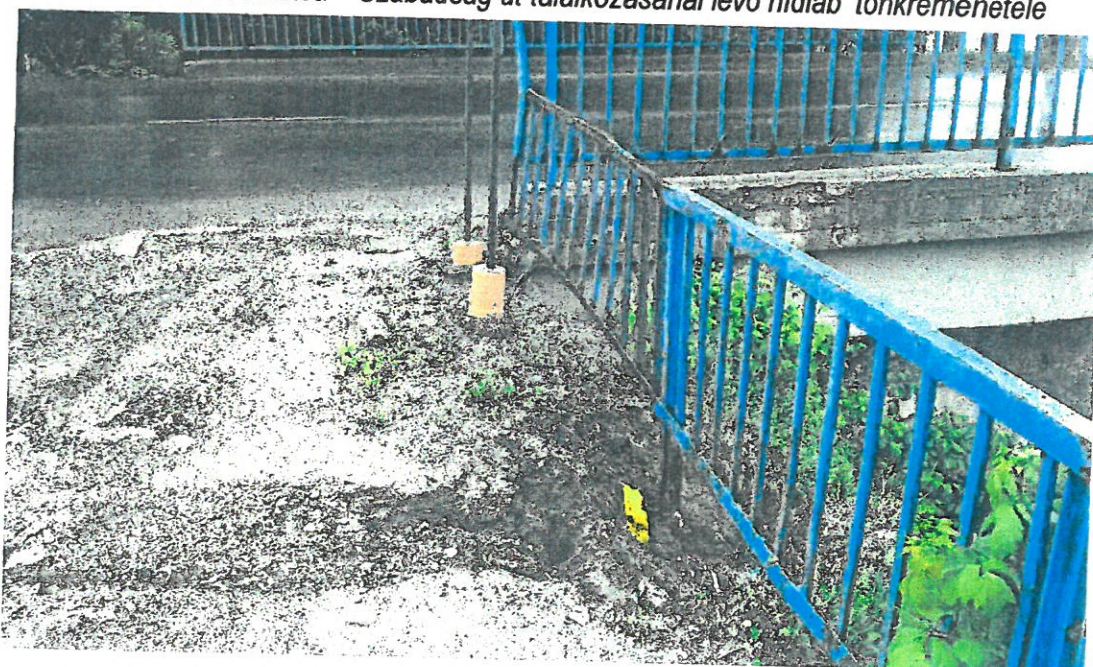
4.1.6.b/ A Szabadság út hídjához csatlakozó hídfők – hídlábak - kimosódása
