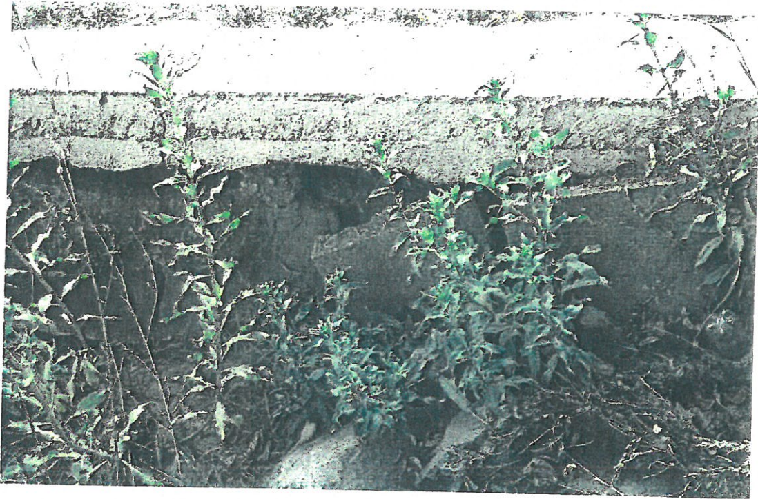
4.3.6.d/ A tönkrement burkolt árok
