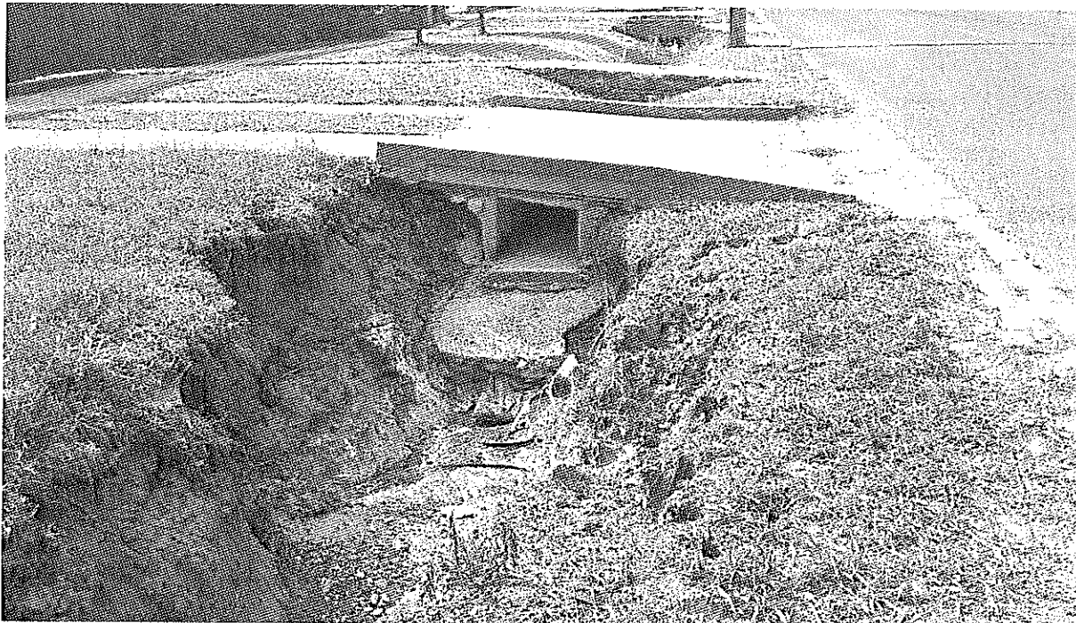
A kimosódott, tönkrement árokburkolat
