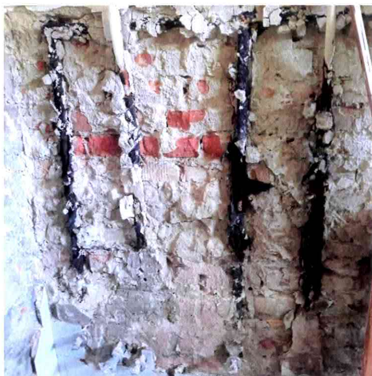
Falban lévő korrodált, lemezesen málló víz vezeték csövek
