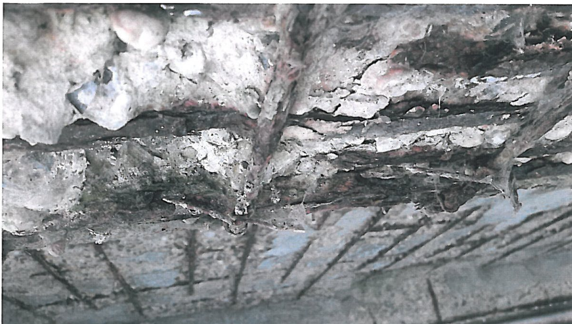
A vasbeton lemez hámlása, acél korrózió
