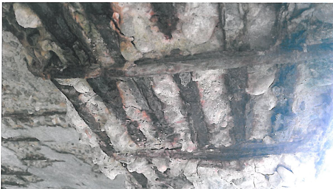
Vasbeton gerenda beton hámlása, fővasak és kengyelek acél korróziója
