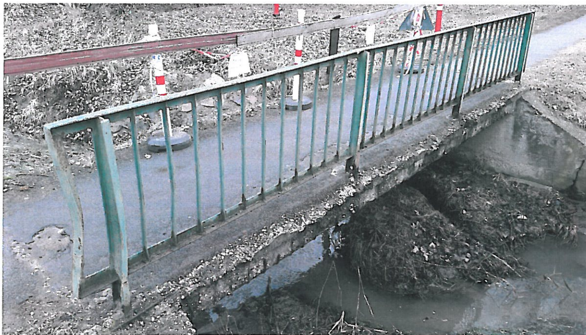
Meglévő/megmaradt korlát korrodált befogással, sérült elemekkel
